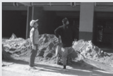
原砂存放凌亂、來路不明 工地安衛及施工品質堪憂
